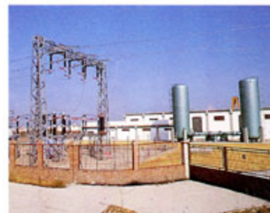
Planta de bombeo para riegos.
