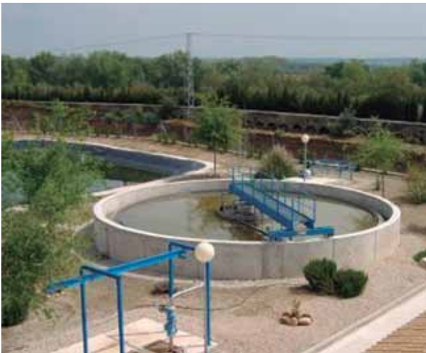
Estación depuradora de aguas residuales
