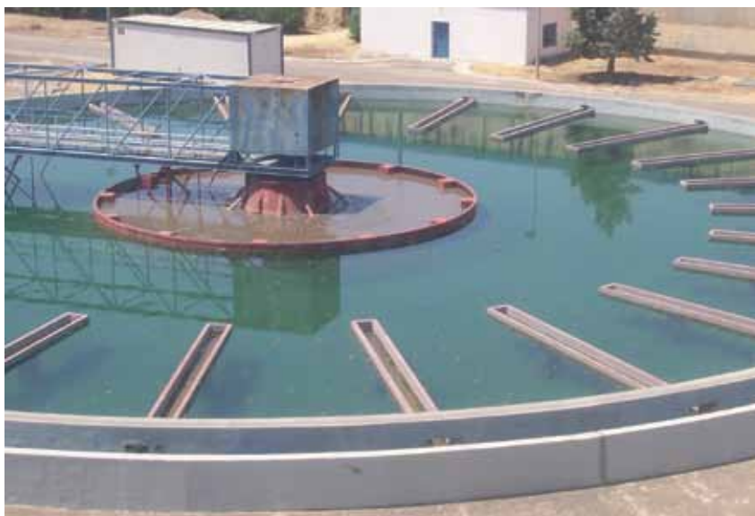
Decantador de una ETAP
