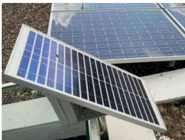
Placas solares instaladas en la azotea de un edificio
