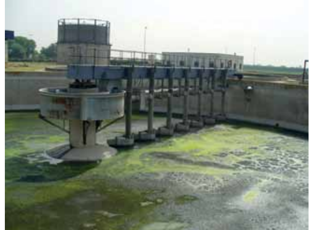
Decantador secundario EDAR de Palomares
