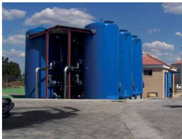
Filtros de carbon activo. ETAP de la Palma del Condado
