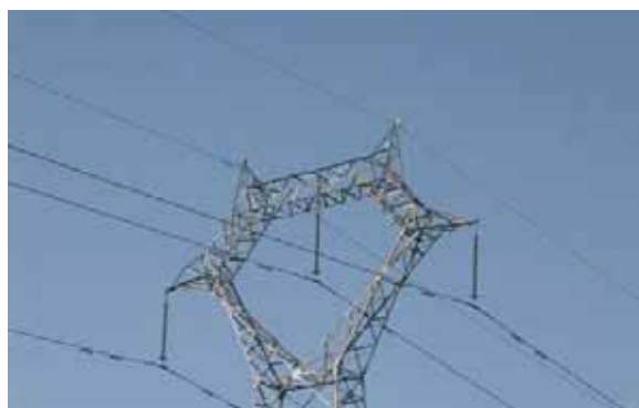
Torre de alta tensión sobre núcleo urbano
