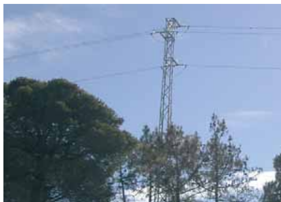
Tendido eléctrico en masa forestal
