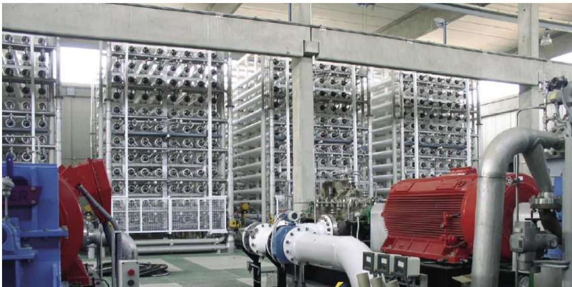
Figura 2.26. Desaladora de Almería
