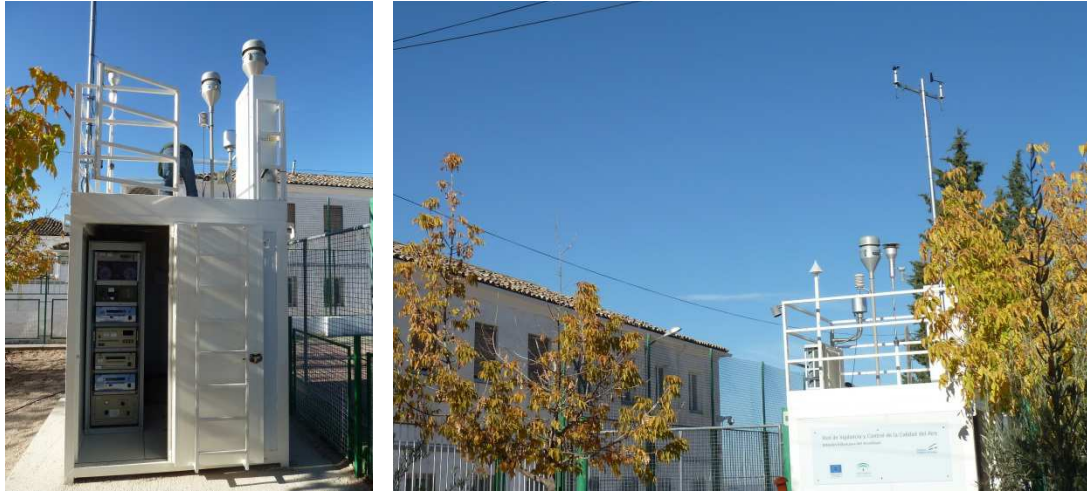
Figura 3.3. Equipos de medida de la estación de Villanueva del Arzobispo en su ubicación posterior a marzo de 2014.
