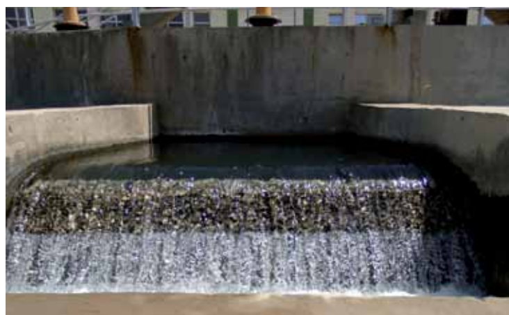
Aguas en la ETAP Montañés. FOTO: CONSORCIO DE AGUAS DE LA ZONA GADITANA.
