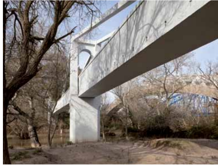
Acueducto-sifón del Guadalete en la Barca de la Florida, en una imagen tomada en 2010. Foto: J. Morón.
