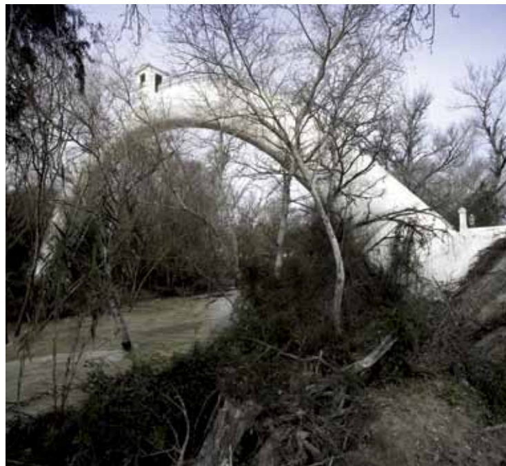
Uno de los sifones de la Junta de los Ríos, para conducir el caudal de riego del Guadalcacín a las tierras situadas en la margen derecha del Guadalete. FOTO: J. MORÓN
