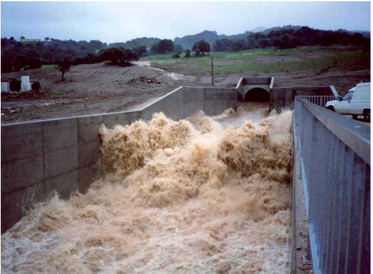
Salida de aguas del trasvase en la Garganta de la Barrida, tributaria del río Majaceite aguas arriba de la presa de los Hurones, en la cuenca del Guadalete. Foto: CONFEDERACIÓN HIDROGRÁFICA DEL GUADALQUIVIR.
