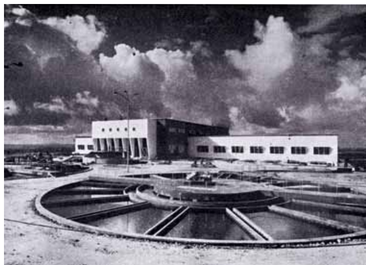
La estación depuradora de Cuartillo, todavía en obras, en una publicación de 1961. FUENTE: CONFEDERACIÓN HIDROGRÁFICA DEL GUADALQUIVIR.
