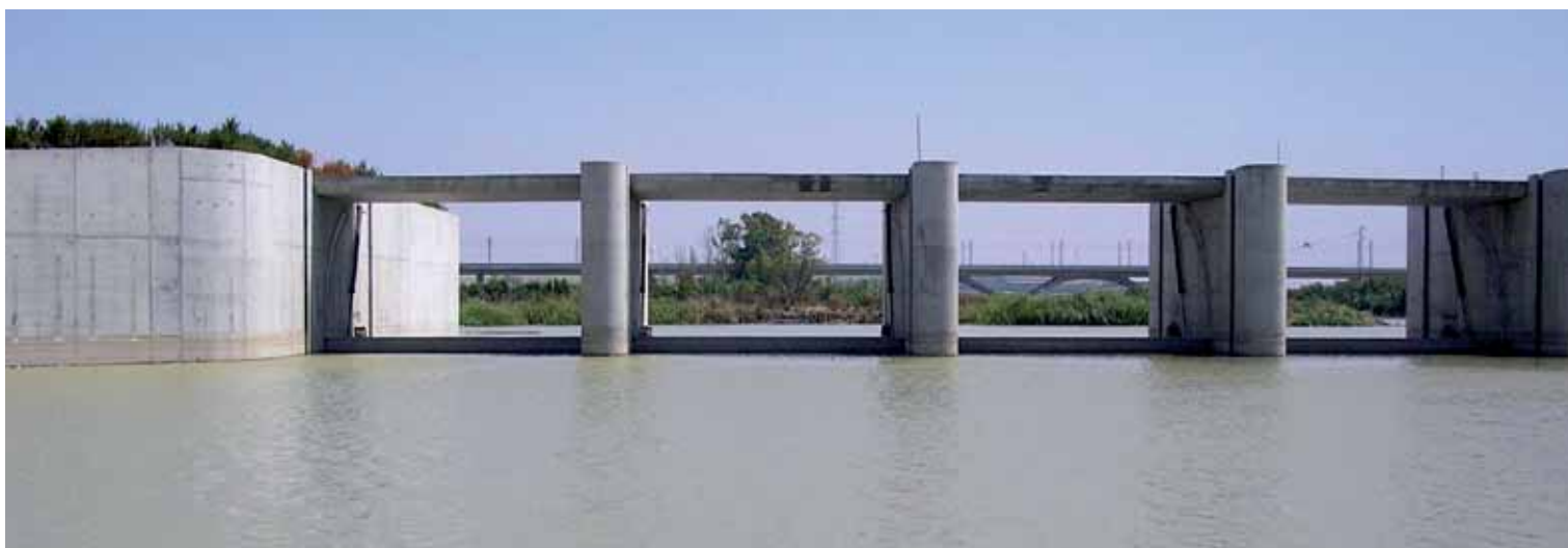
Nuevo azud de El Portal, en el término municipal de Jerez de la Frontera. Foto: E. Rubio.
