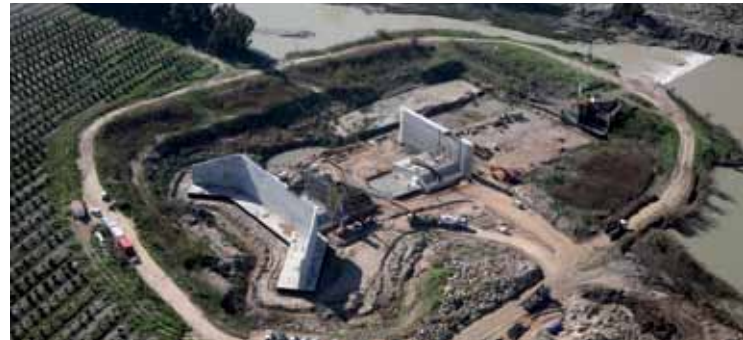
Vista aérea de las obras del tramo nuevo del azud de El Portal durante el hormigonado. Foto: F. ZAMBRANO.
