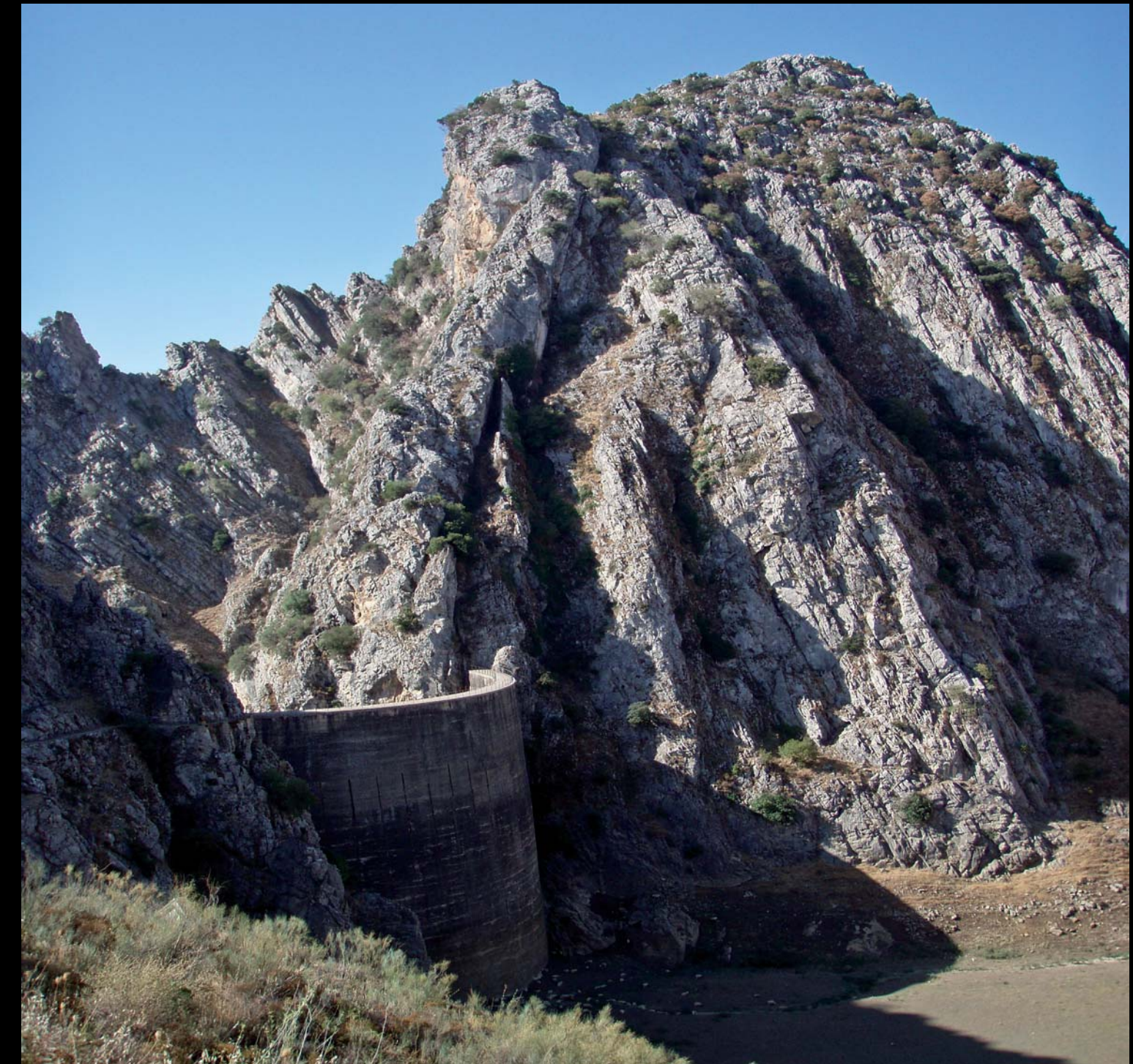
Panorámica de la presa del embalse de Montejaque (Málaga), inicio y recarga superficial del sistema Hundidero-Gato. Fue uno de los primeros fracasos hidráulicos en nuestro país relacionado con acuíferos kársticos (foto: J. Enrique Sánchez)
