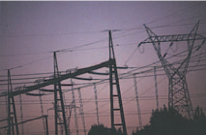
Subestación eléctrica. Dormidero habitual del cernícalo primilla
