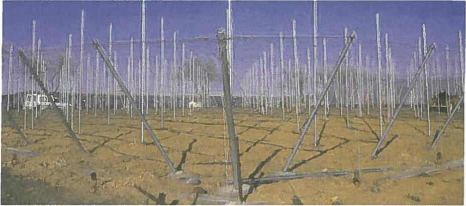
Parral con tubos galvanizados
