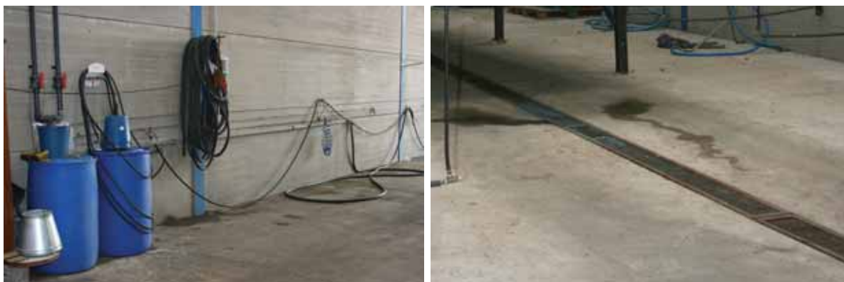
Figura 5. Equipo de limpieza a presión (izquierda) y canaleta de recogida de efluentes (derecha) en un centro de limpieza y desinfección de vehículos
