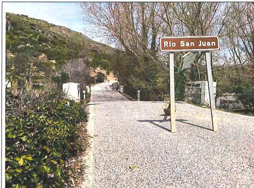
Foto 1.- Vista del firme deformado sobre el puente desde la margen izquierda del río San Juan (lado Castillo de Locubín)
