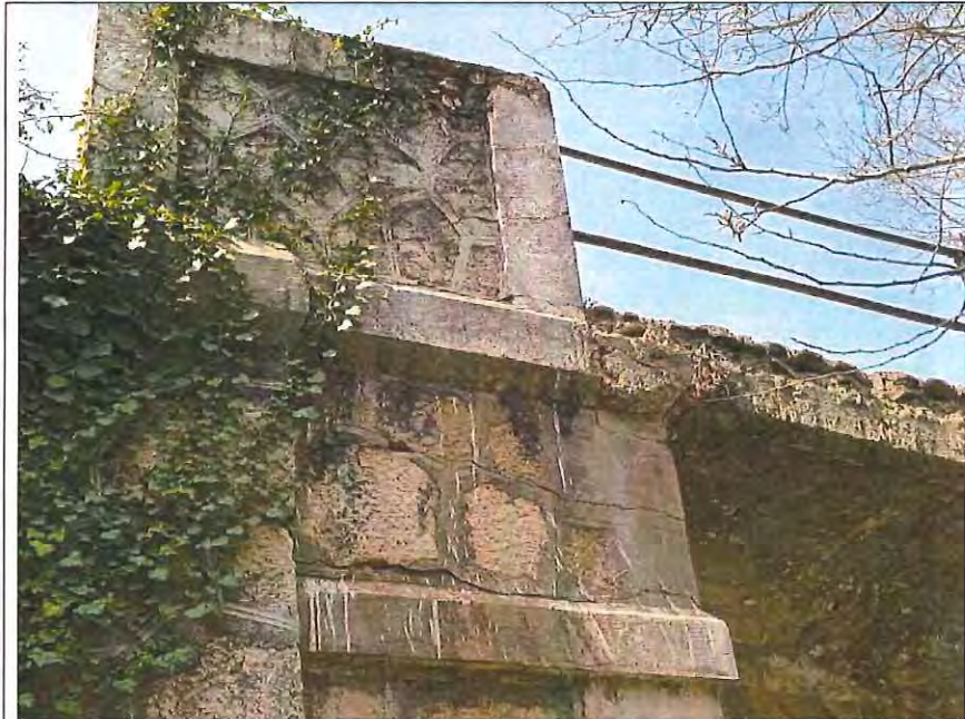
Foto 9.- Vista de grietas en la coronación del estribo, donde se produce el apoyo del tablero.
