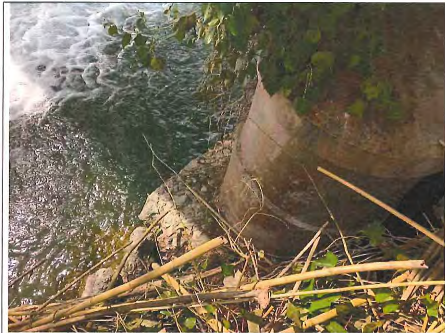
Foto 21.- Vista del cauce del río y del apoyo en falso de la pila central, desde aguas arriba.
