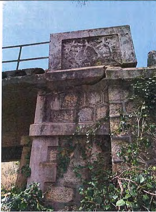
Foto 15.- Rotura de la parte superior del estribo de la margen derecha, visto desde aguas abajo.
