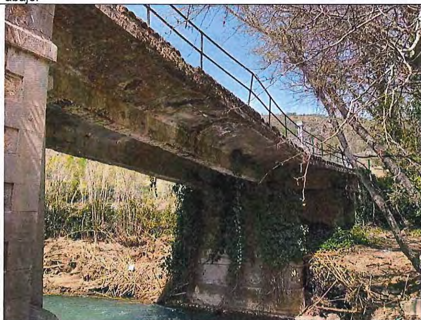
Foto 8.- Estribos, pila central y tablero desde la margen izquierda del río San Juan, visto desde aguas arriba.
