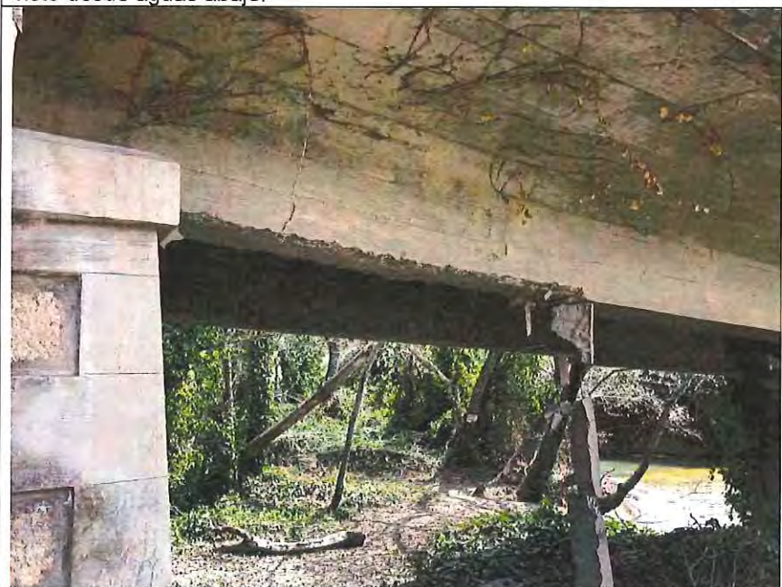
Foto 14.- Desprendimiento del revestimiento de mortero del tablero, visto desde aguas abajo.
