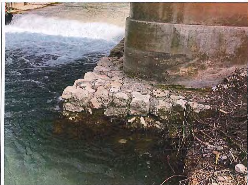
Foto 7.- Estado del cemento del estribo de la margen izquierda desde aguas abajo.
