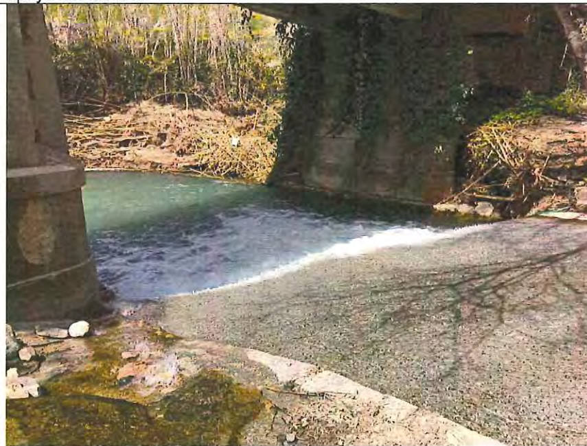
Foto 10.- Vista del cauce del río San Juan desde aguas arriba. El caudal discurre entre el estribo izquierdo y la pila central.
