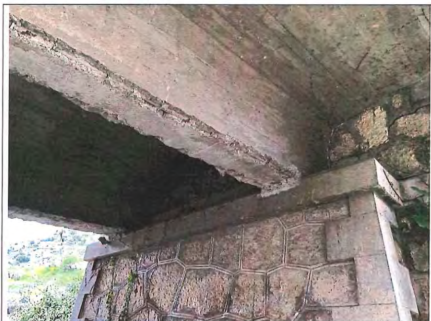
Foto 17.- Detalle del apoyo del tablero sobre el estribo, en el que se puede apreciar la falta de recubrimiento de la armadura.
