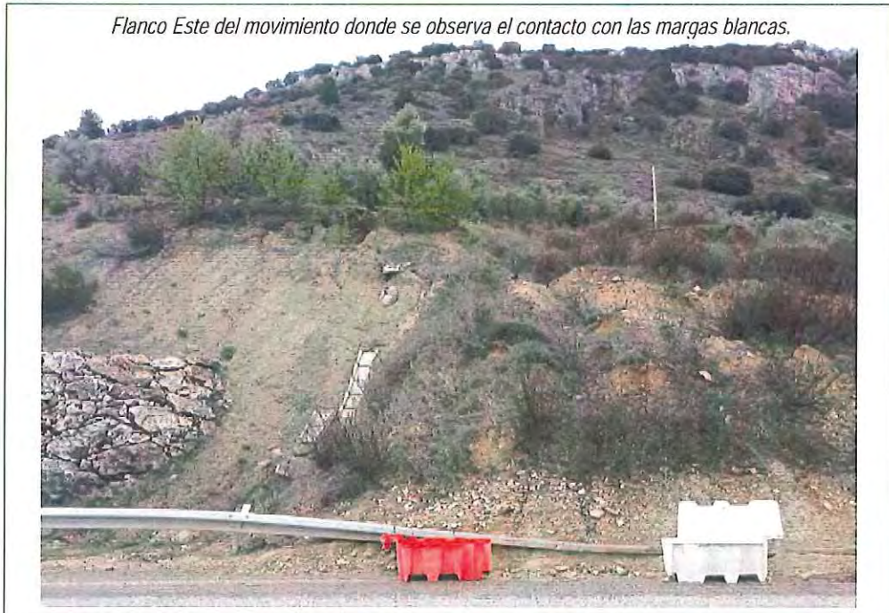
Zona de deformaciones y fisuras.
