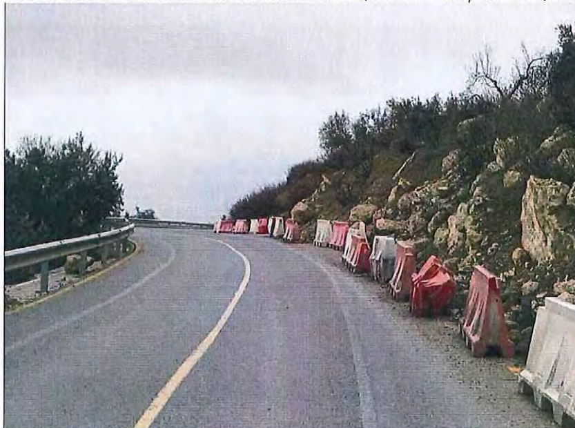
Vista de la situación actual con la situación de las barreras, en sector más próximo a Quesada.
