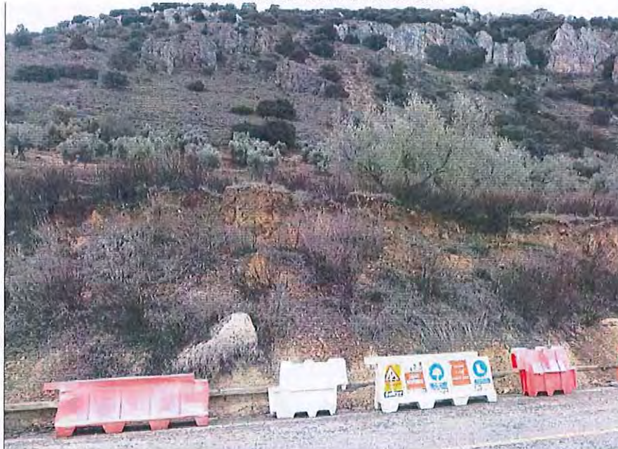
Zona de talud en desmonte deformada.
