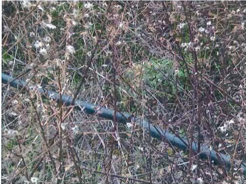
Unión de tubería de riego rota, muy frecuente en la zona.
