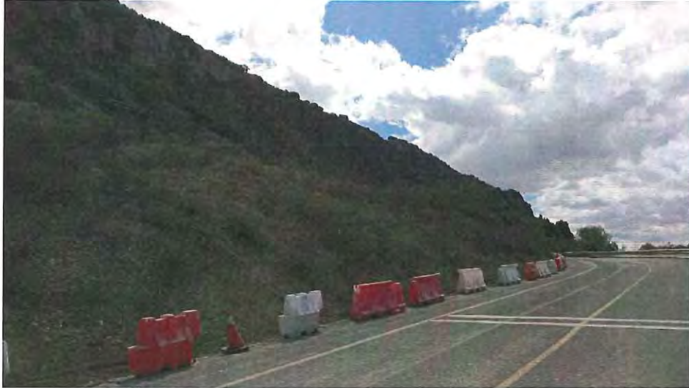
Invasión producida por los materiales movilizados sobre la calzada.
