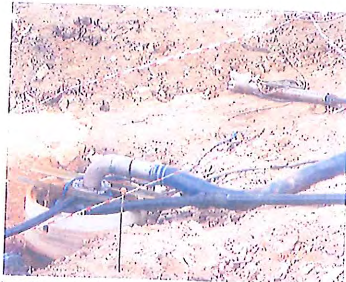
El total del agua filtrada se recoge con el bombeo instalado en el interior de este anillo de hormigón. Indar R350 de 55 kw.
