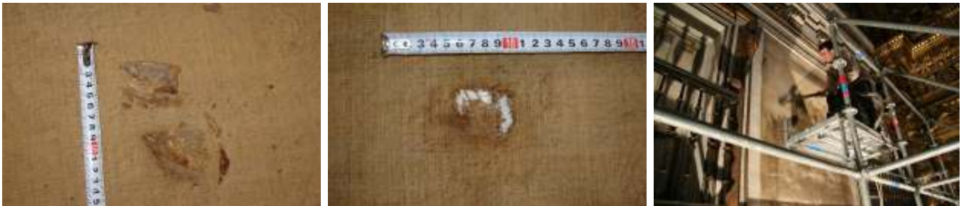
Fotos 33 y 34 (repetición). Eliminación del parche y la cera-resina. Foto 133. Limpieza del muro subyacente.
