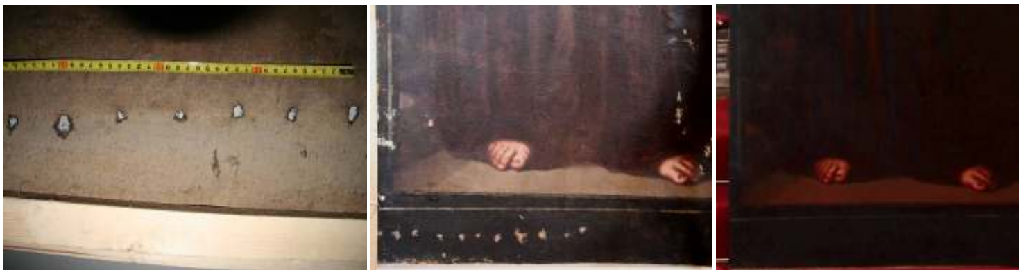
Fotos 110 a 112. Detalles del reverso del cuadro, aspecto de las perforaciones por clavarlo a la pared y aspecto final de esta zona.
