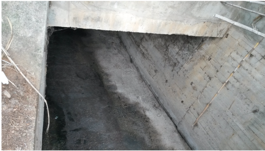
Figura 1.6: Desembocadura del colector de pluviales procedente de la Avenida Parménides.
