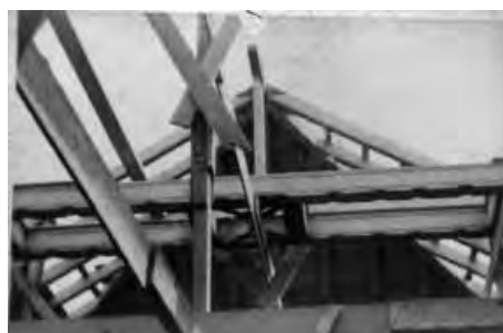
Armadura desmantelada del salón principal
