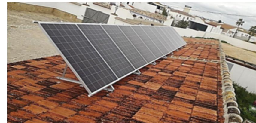
Imagen 2. Instalación fotovoltaica no integrada en cubierta
