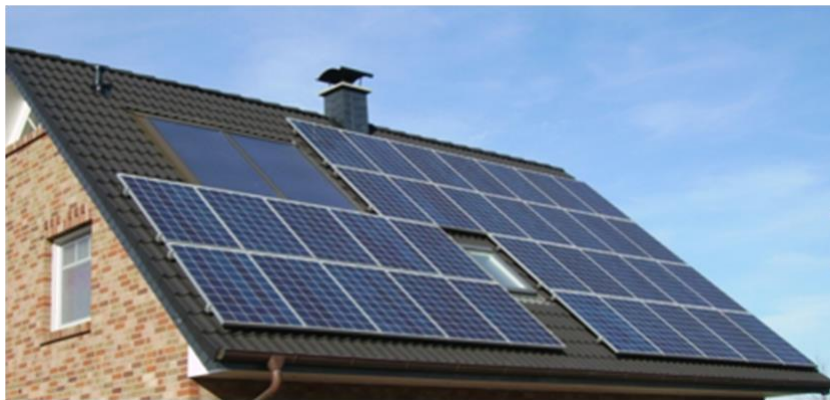
Imagen 1. Instalación fotovoltaica integrada en cubierta
