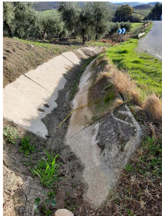
Cuneta sentido creciente
