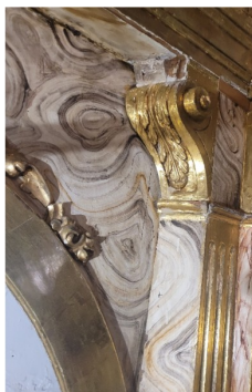
Policromía de la embocadura (Imagen de inspección).
