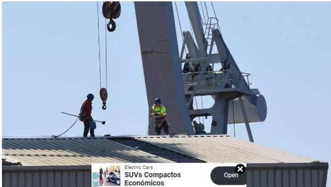
Dos operarios trabajando este miércoles en una cubierta de San Enrique, horas después del siniestro / RICARDO
