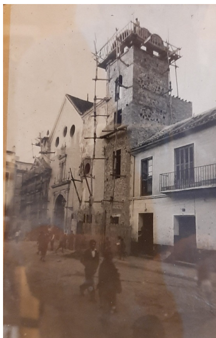
Imagen de la construcción de la torre campanario (1943-1945) en la que se aprecian las construcciones adosadas a la iglesia.
