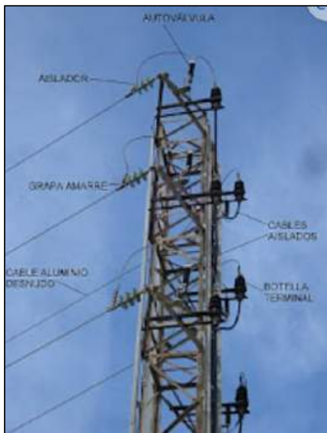
Figura 19. Unión conductor aéreo-pararrayos autoválvula-terminal.
