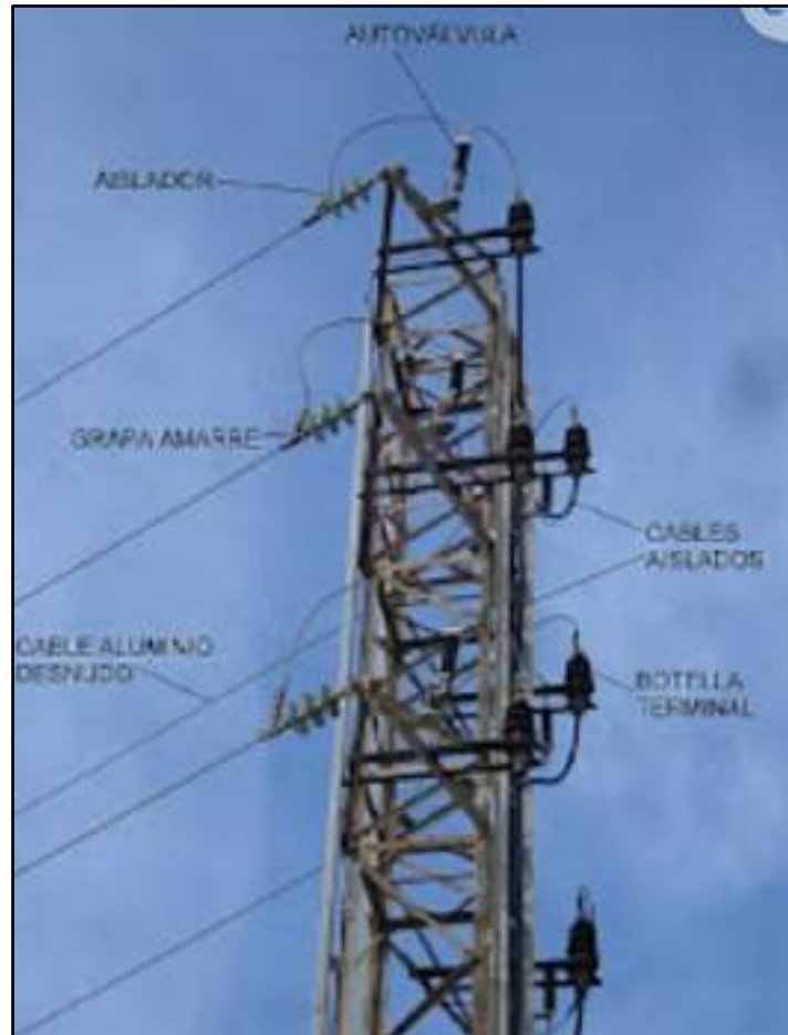
Figura 6. Unión conductor aéreo-pararrayos autoválvula-terminal.
