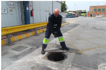
Antes: Medición diaria de los 9 tanques de combustible a través de una varilla calibrada levantando las tapas de los mismos
