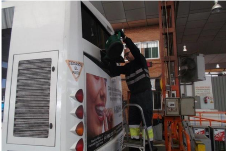
Antes: Reposición de refrigerante con garrafa y escalera
