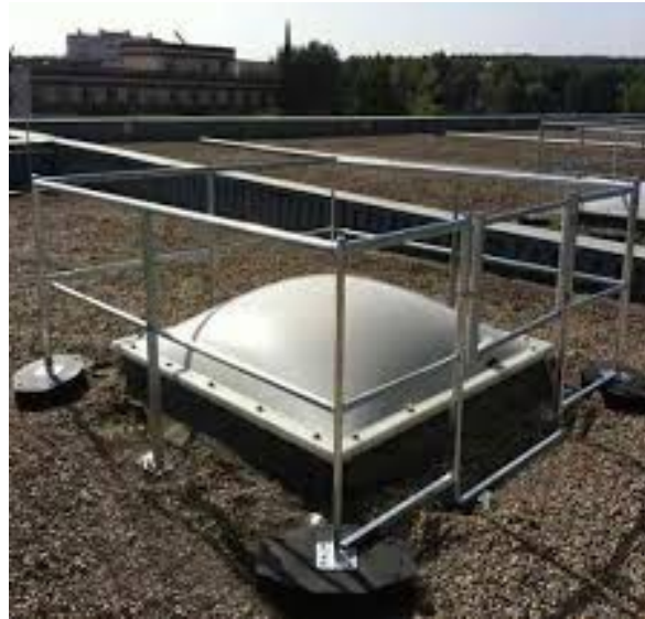
Figura 33. Medida contra caídas de altura en claraboyas/lucernarios tipo barandilla (Fuente: Securman. Protección en altura, 2022)
