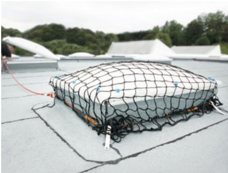
Figura 36. Medida contra caídas de altura en claraboyas/lucernarios tipo red textil (Fuente: Taludia. Traslúdicos y claraboyas, 2022)
