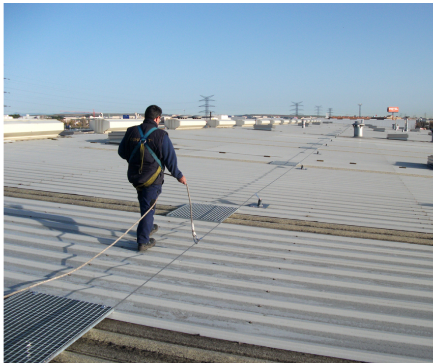
Figura 39. Línea de vida y protección individual (Fuente: Conaprosl, 2022)
