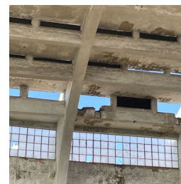
Faltas en vigas de hormigón
