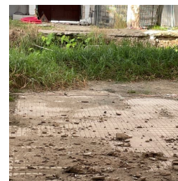
Vegetación cubriendo pavimento
