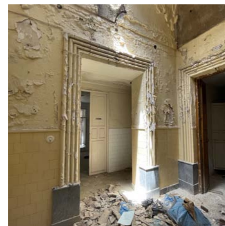
Patologías interiores. P.Primer
