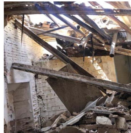
Colapso de la cubierta
