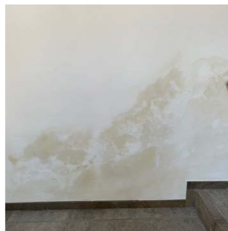
Humedades en la escalera
