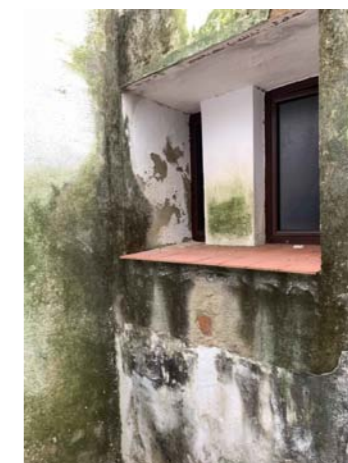
Humedades en patio interior
