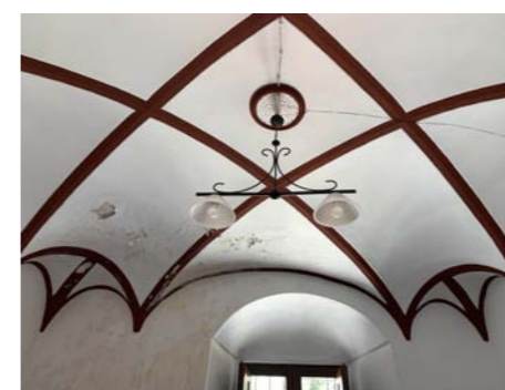
Bóveda en p. baja con humedad
