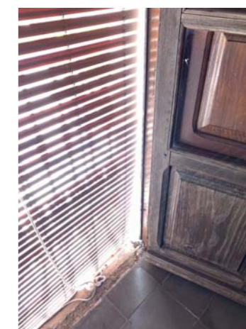
Detalle estado de carpinterías
