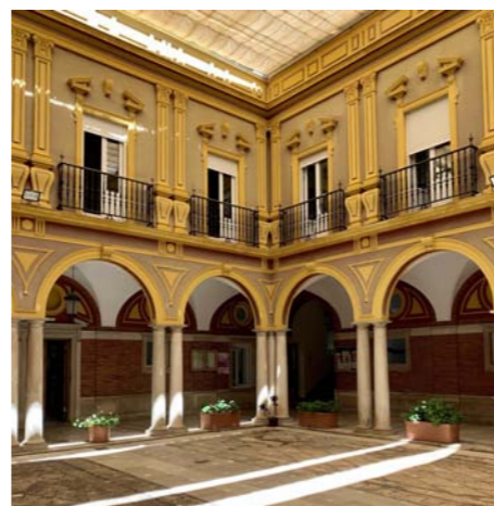
Patio con estado de pavimento
