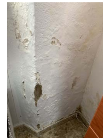
Humedades en muros de p. baja
