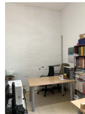
Despacho de p. baja con humedades
