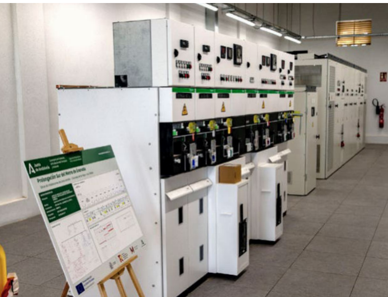
Subestación eléctrica de San Cayetano.
